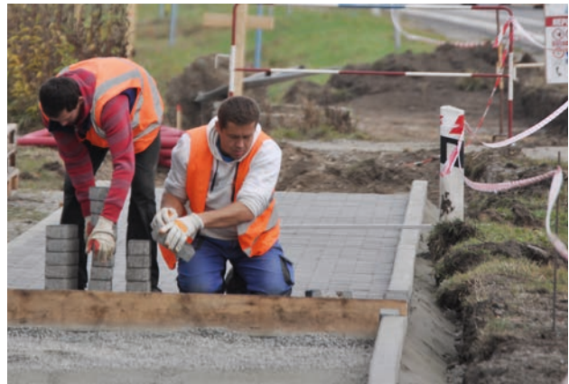
Chodníky se opravovaly na ul. J. Palacha, Březinova, Haškova, Veslařská, Jiráskova, Skopalíkova, Lidická, Gagarinova, Šmeralova a Na Zvolenci.
